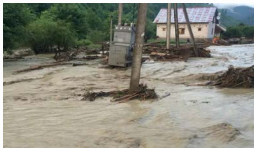
підтоплення територій під час злив
